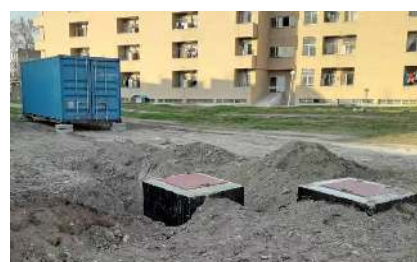
图 2 运抵示范工程现场的一体化生活污水处理装置
